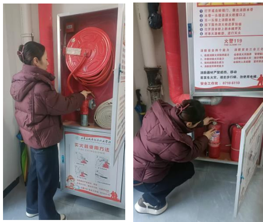
图 81 定期检查消防设备图
