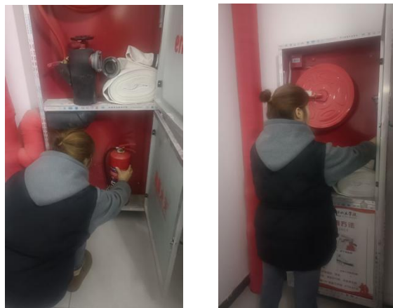
图 82 定期检查消防设备图
